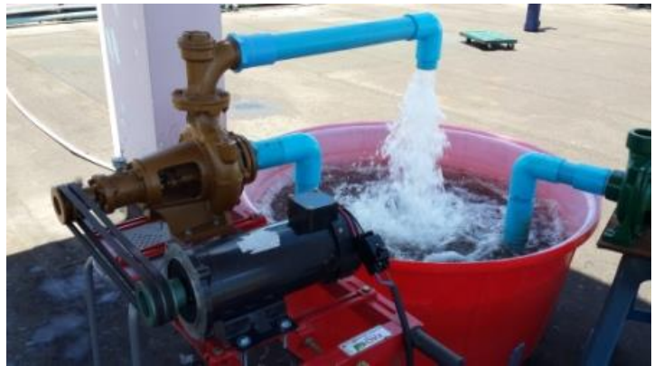
มอเตอร์ DC ต่อกับปั๊มหอยโขง
